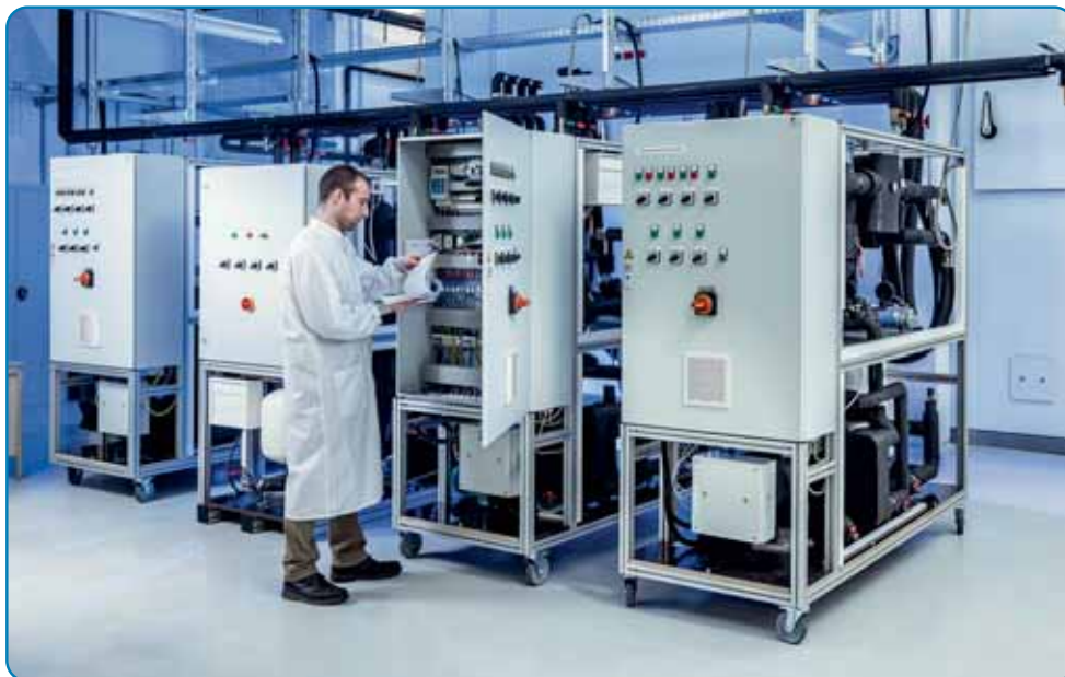
Hydraulikmodule zur Emulation von Quellen und Senken des Wärmepumpenprüfstandes. Hydraulic modules for the emulation of sources and sinks of the heat pump testing stand.
