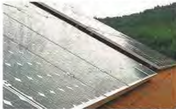
An der Grundschule Amelgatzen sorgte die Genossenschaft „Bürger-Energie Hummetal“ für eine Solaranlage. Im großen Stil errichtet in Erlangen ein Bürgerverein Photovoltaikanlagen. ARCHIV: LL
