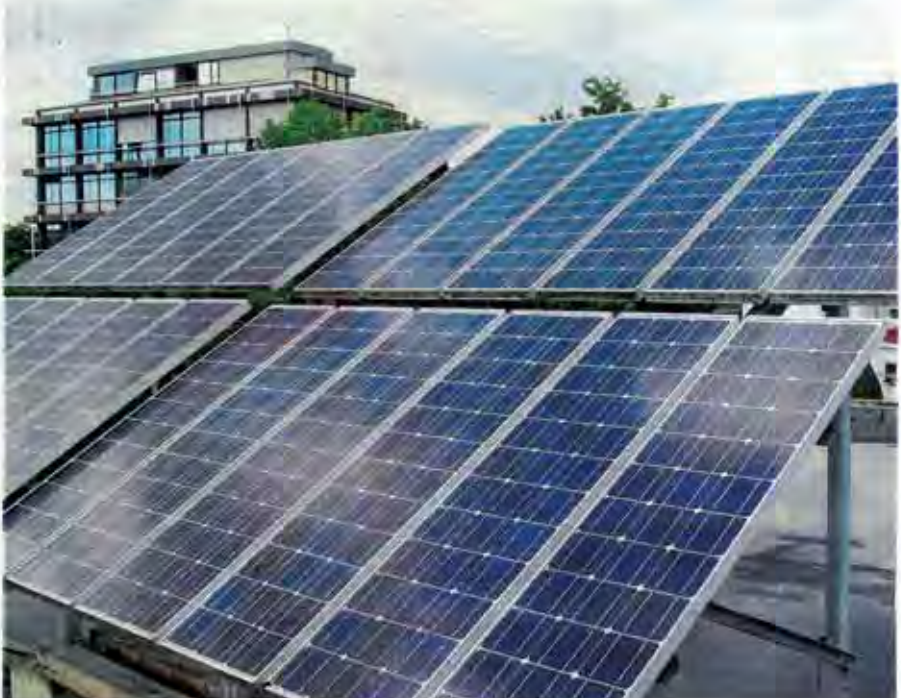
Auch die Stadtwerke Hameln betreiben mehrere Photovoltaikanlagen – unter anderem auf dem Betriebsgebäude an der Halberstraße.
