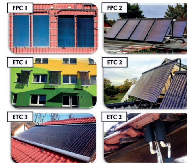
Abbildung/Figure 39: Kollektorinstallation der fünf Demonstrationsanlagen, bestehend aus zwei FPC-Anlagen und drei ETC-Anlagen. Das FPC 1-System wird parallel zu einer vergleichbaren Referenzanlage am ISFH betrieben. Collector installation of the five demonstration systems, consisting of two FPC systems and three ETC systems. The FPC 1-system is operated in parallel with a comparable reference system at ISFH.
