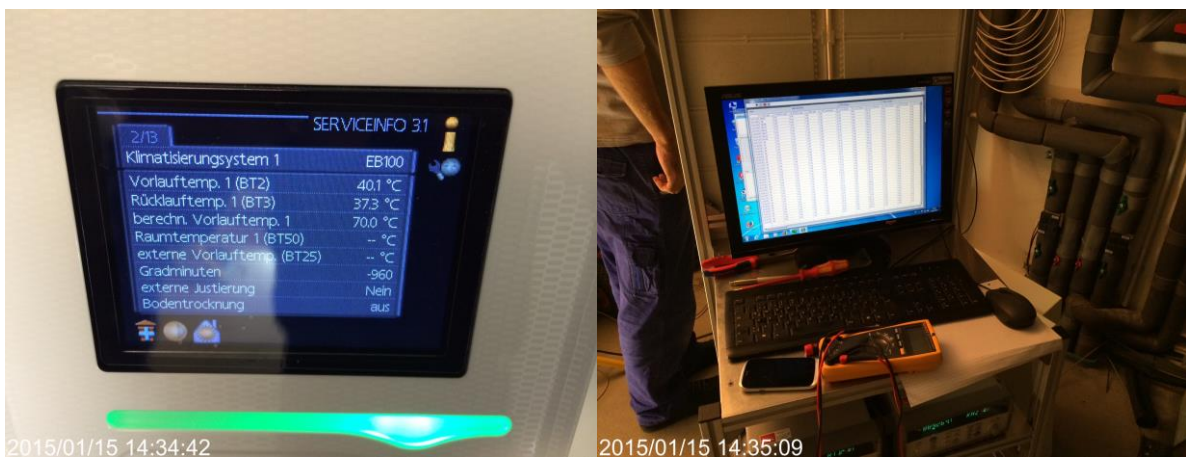
Abbildung 4.25: Inbetriebnahme von Wärmepumpe und Messtechnik
