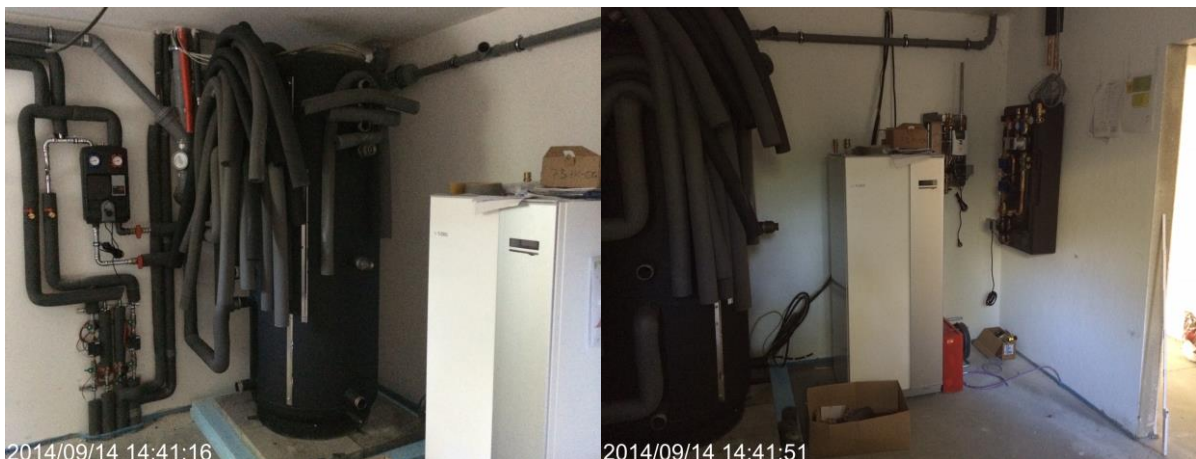
Abbildung 4.23: Aufstellung von Pufferspeicher und Wärmepumpe
