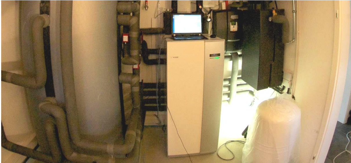
Abbildung 4.4: Wärmepumpe im Heizungsraum des Experimentalgebäudes
