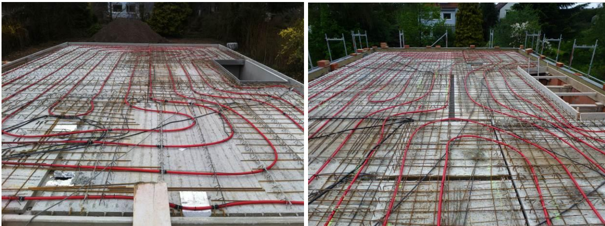
Abbildung 4.5: Bifilare Verlegung der Bauteilaktivierungsrohre im EG (links) und OG (rechts). Der mittlere Verlegeabstand beträgt 50 cm.
