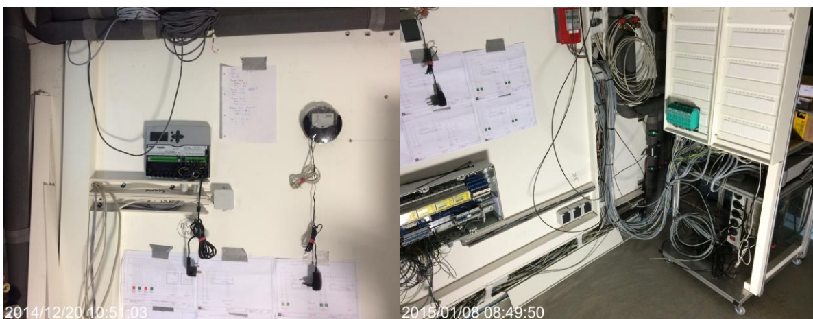
Abbildung 4.24: Installation von Regelung und Messtechnik
