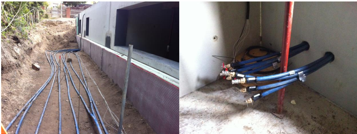
Abbildung 4.18: Zuleitung und Einführung der Erdkolektoren
