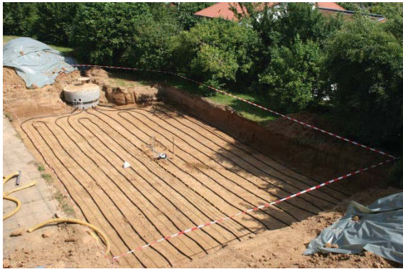
Abbildung 5: Am ISFH errichteter Erdwärmekollektor
